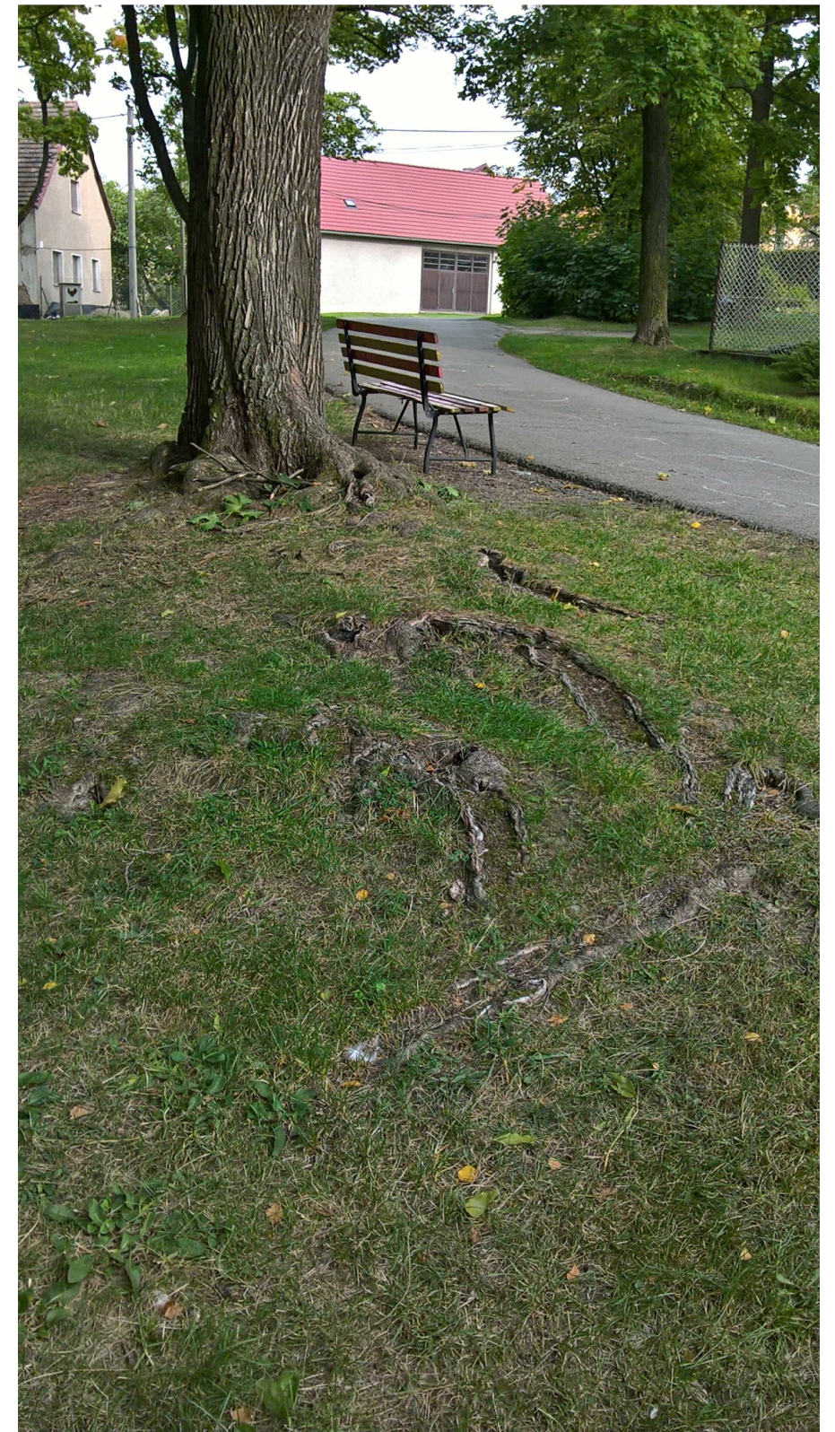
OK - 25, javor - poškozené kořenové náběhy provozem
